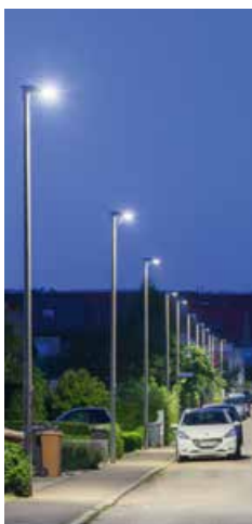
Die EVN bietet eine Beleuchtungslösung, die hocheffizient, flexibel und auf dem neuesten Stand der Technik ist.
