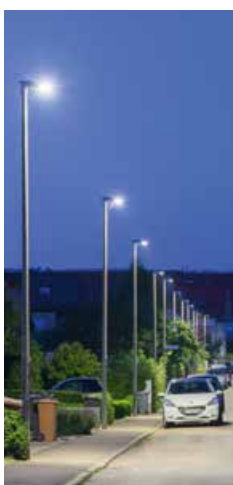
Die EVN bietet eine Beleuchtungslösung, die hocheffizient, flexibel und auf dem neuesten Stand der Technik ist.
