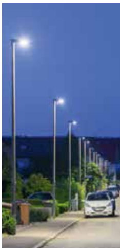
Die EVN bietet eine Beleuchtungslösung, die hocheffizient, flexibel und auf dem neuesten Stand der Technik ist.
